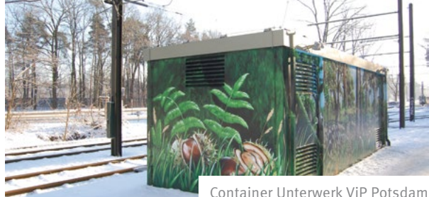
Container Unterwerk ViP Potsdam
