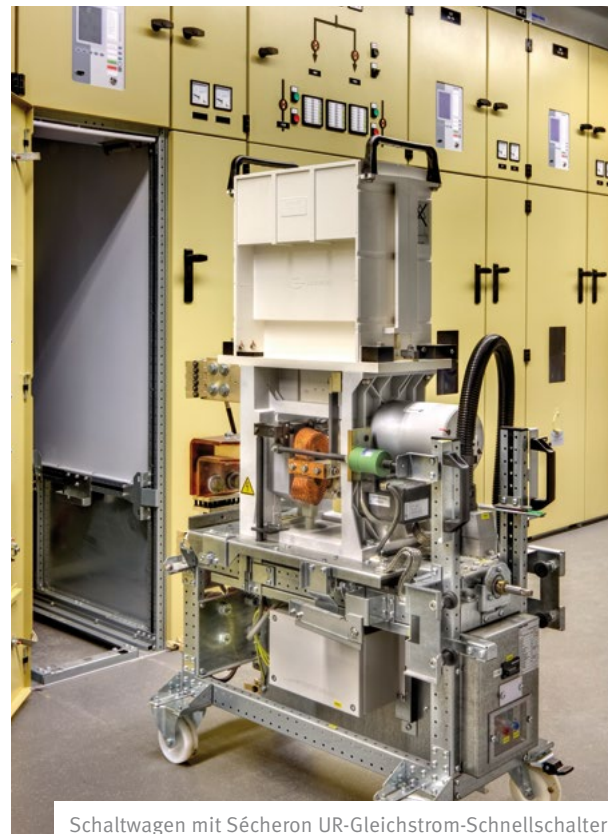
Schaltwagen mit GE Gerapid Gleichstrom-Schnellschalter
