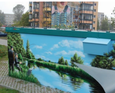
Schlüsselfertige Unterwerke – wie hier für VIP Potsdam
