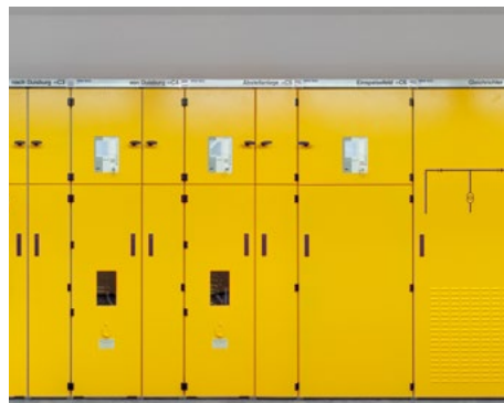
Schaltanlage – bedarfsgerecht zusammengestellt
