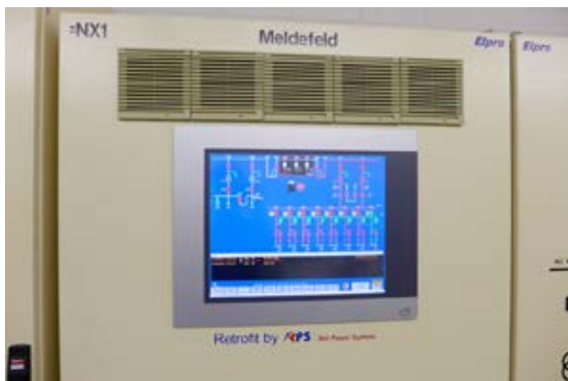
Bild 4: Melde- und Bedienfeld nach dem Umbau.
