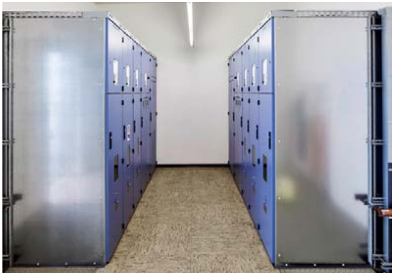
Bild 9: DC-Schaltanlage TracFeed® TDA-L der G UW 107 und 108 in gegenüberstehender Aufstellung; von hinten nach vorn: Gleichrichterzelle, Einspeise- und Rückleiterzelle, 3x Streckenabgangszelle.
