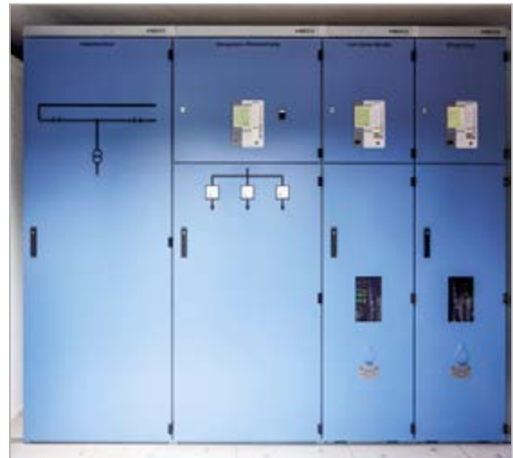
Bild 6: GUW-Innenansicht mit Gleichrichter und DC-Schaltanlage; von links nach rechts: Gleichrichterzelle, Einspeise- und Rückleiterzelle, 2 x Streckenabgangszelle.
