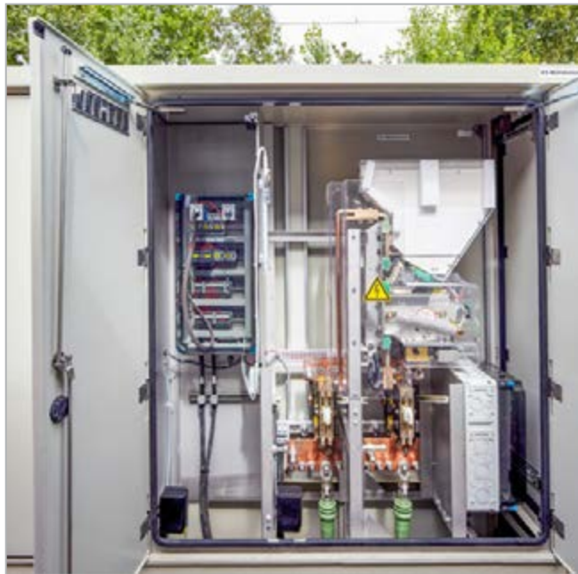
Bild 8: Außenschrank mit Kuppellastrrennschalter.
